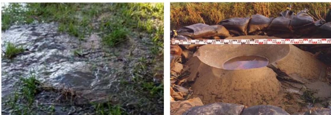
Abb. 2: Durch Risse in der Deckschicht austretendes Qualmwasser (links) und die Bildung sandender Auswurftrichter (rechts) sind Anzeichen für rückschreitende Erosion
