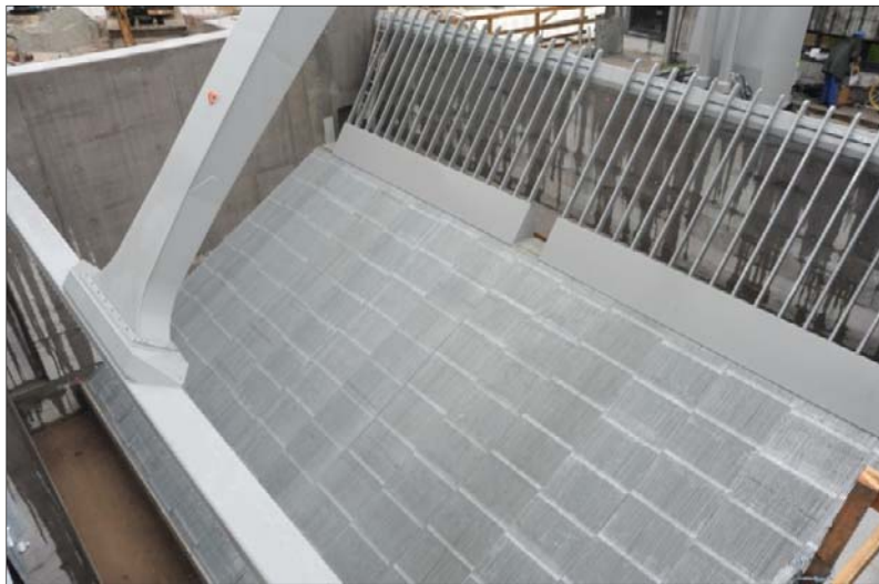
Abb. 7: Vertikalrechen mit 10 mm Stababstand, oberflächennahe Bypassöffnungen für Lachsmolts zur Spül- und Bypassrinne (WKA Willstät / Kinzig, Q_A = 25 \text{ m}^3/\text{s} ).
