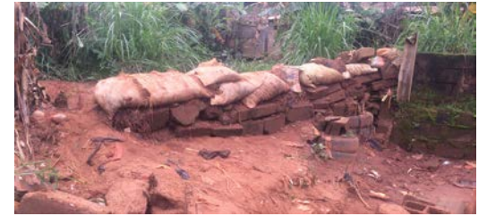
Abbildung 3: Behelfsmäßige Reparatur einer eingestürzten Hochwasserschutzmauer. Quelle: IWW, RWTH Aachen University
