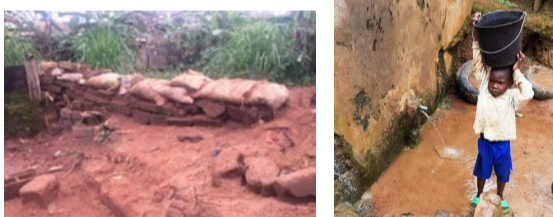
Abb. links: Eingestürzte Hochwasserschutzmauer mit provisorischer Reparatur durch Sandsäcke; Abb. rechts: Kind holt Wasser von ungefilterter Wasserstelle (Quelle: IWW)
